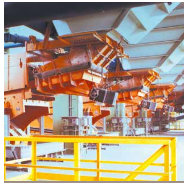
Elektromagnetische Vibrationsförderrinnen in einer Hochofenbemöllerung Electromagnetic feeders feeding vibrating screens from day bunkers at a blast furnace
